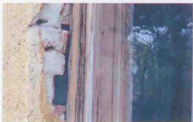
Vakolat mállás - nyílászárók
