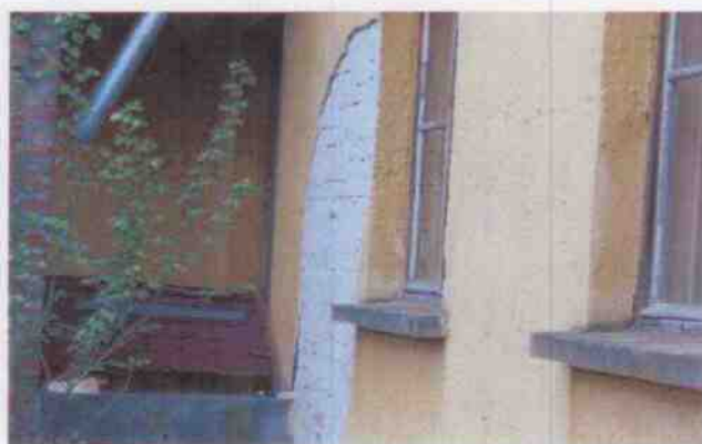
Vakolat mállás - nyílászárók
